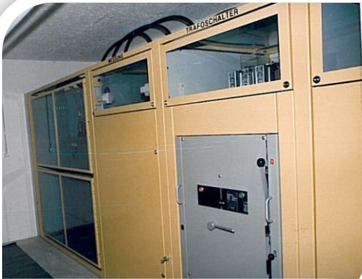
TRAFOSTATION PANZERSCHIESSPLATZ, WICHLEN/-ELM
