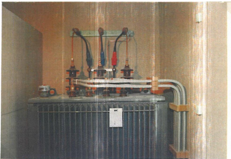
TRAFO 16 kV/400 kVA PZ.SCHPL.WICHLN /ELM
